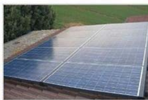
altri impianti fotovoltaici
